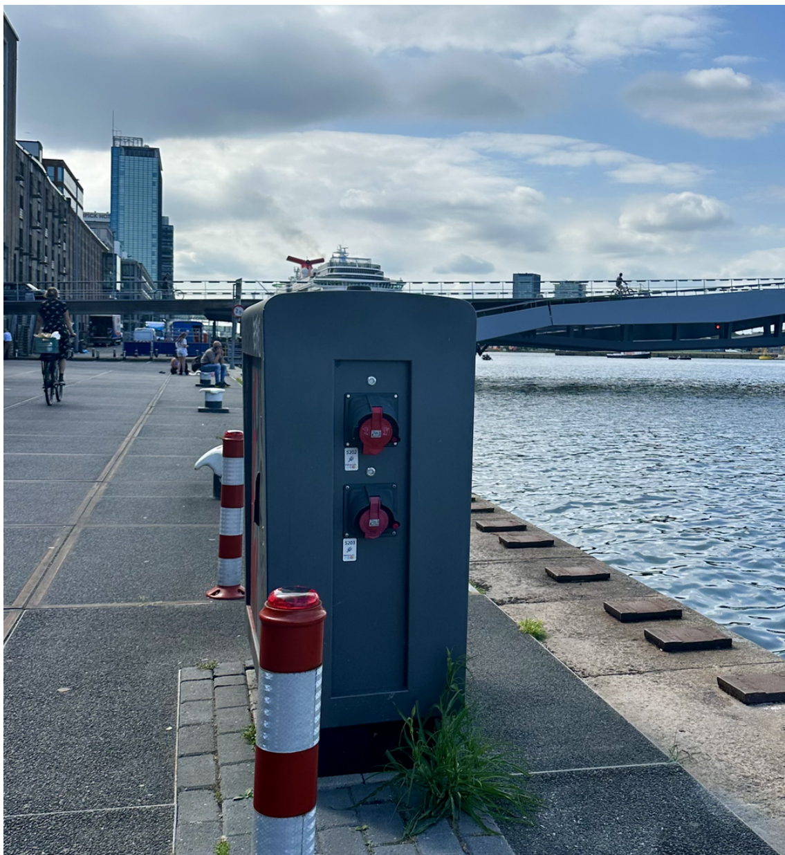
Een walstroomaansluiting voor afgemeerde binnenvaartschepen
